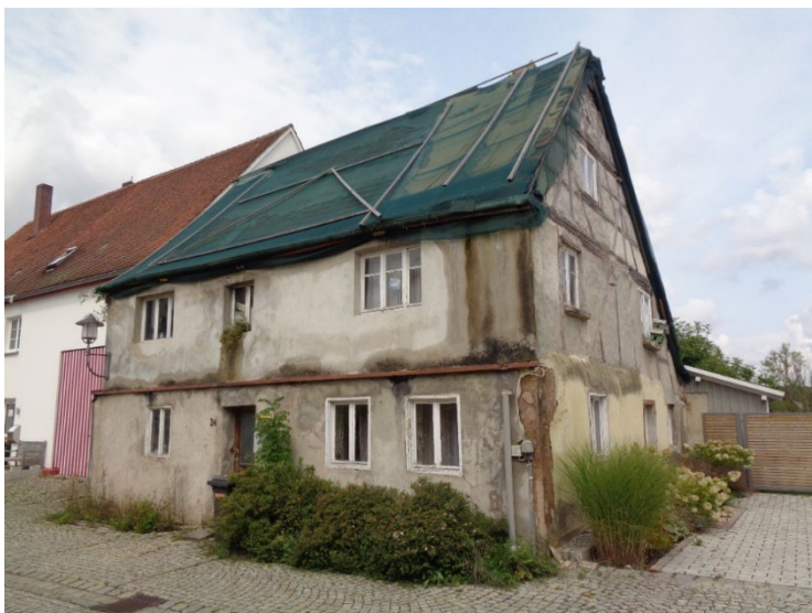
Abb. 71: das Gebäude in der Sulzacher Str. 24 wird nur schwer zu erhalten sein
