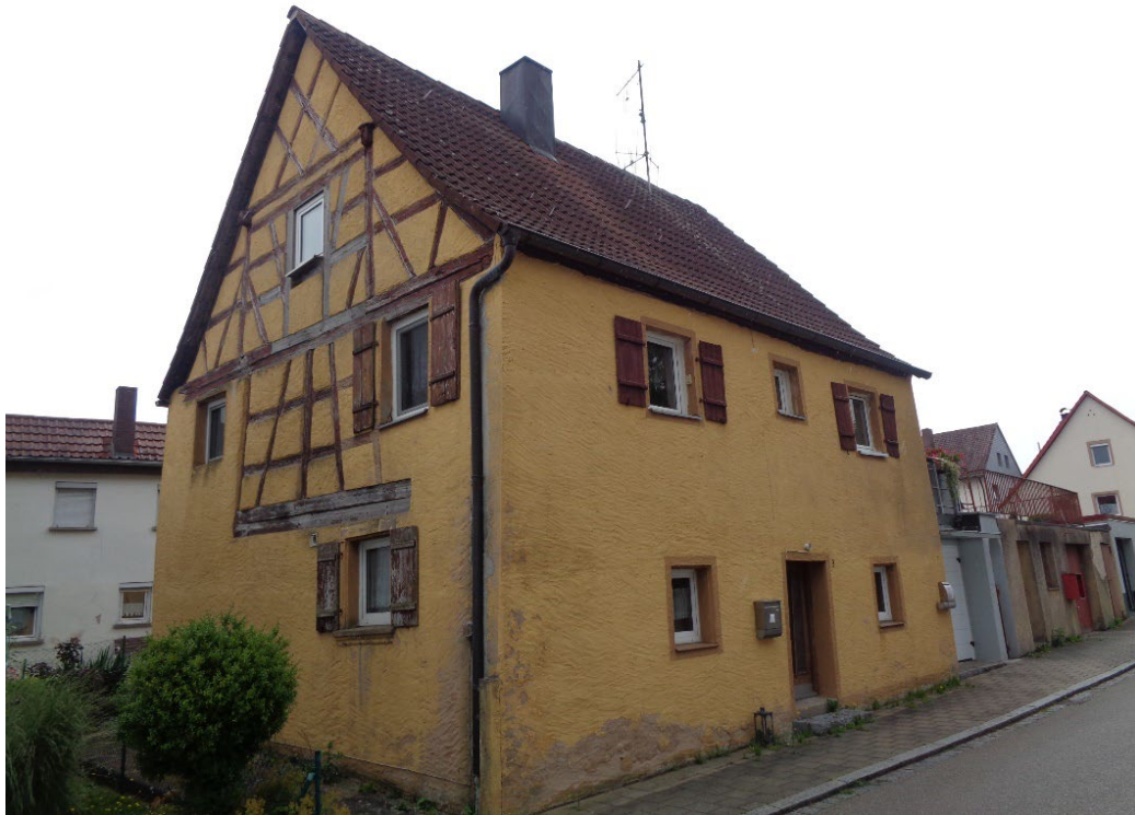
Abb. 72: Das Gebäude der Mühlgasse 3 und 5 bedarf einer Sanierung. Noch ist es bewohnt
